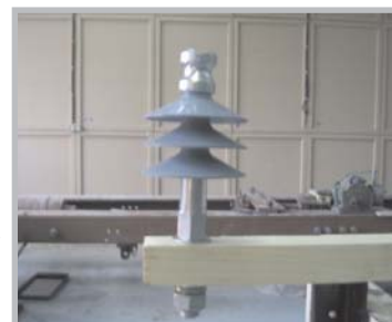
Вид установленного изолятора на деревянной траверсе
