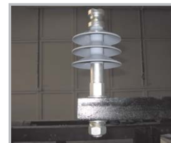
Вид установленного изолятора на металлической прямоугольной траверсе
